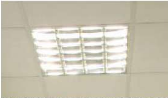
APPARECCHI DI ILLUMINAZIONE GENERALE
